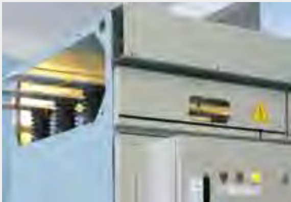
Рис. 5.2. Отсек сборных шин
