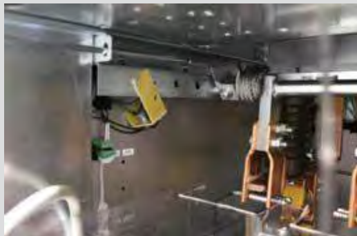
Рис.1.54. Размещение фототиристора в отсеке присоединений
