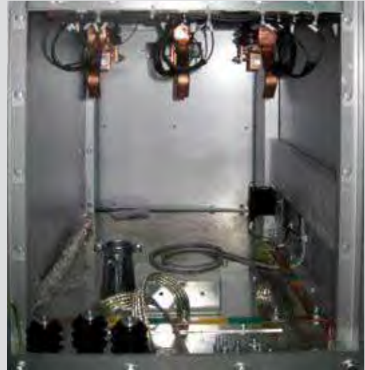
Рис. 1.13. Доступ с тыльной стороны шкафа (вид с открытой дверью)
