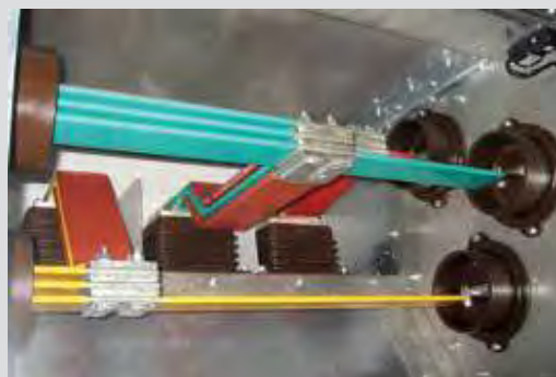
Рис. 1.8. Опорные изоляторы сборных шин в крайнем шкафу секции КРУ
