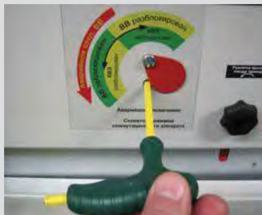
Рис. 2.25. Ручное отключение выключателя ISM15_Shell с фасада шкафа
