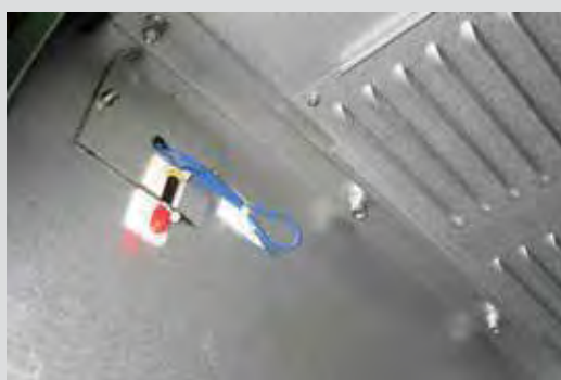
Рис.1.56. Волоконно-оптический датчик в отсеке сборных шин
