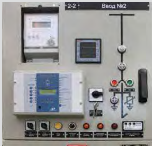
Рис. 1.14. Фасад релейного отсека
