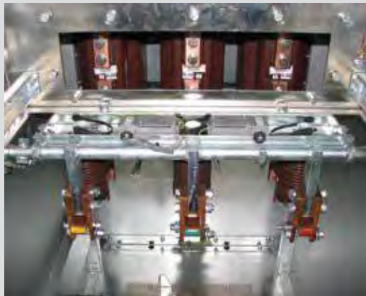
Рис 1.34. Концевые выключатели на панели заземлителя
