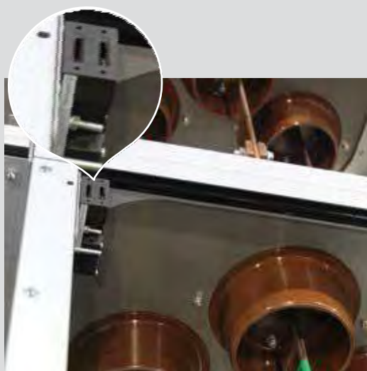
Рис. 1.32. Концевой выключатель в отсеке сборных шин
