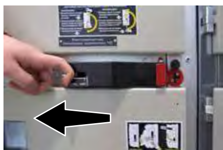
Рис. 2.7. Электромагнитная блокировка Y81
