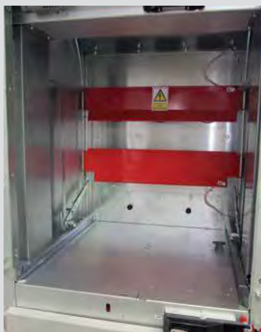
Рис. 1.9. Отсек выдвижного элемента при извлеченном КВЭ
