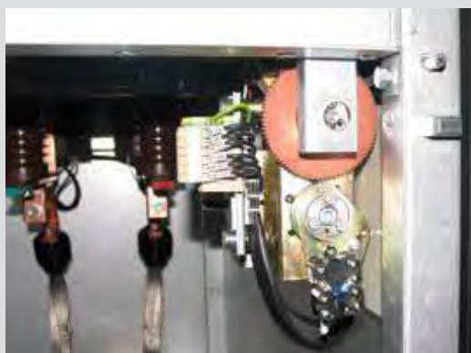
Рис. 2.30. Электропривод заземлителя (вид при открытой двери отсека)
