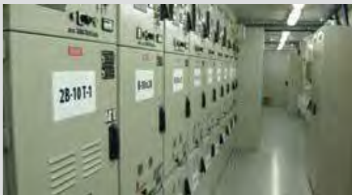
Рис.1.3. Шкафы КРУ в составе модульного здания SKP
