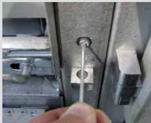
Рис. 2.23. Механизм деактивации блокировки (вид при открытой двери отсека)
