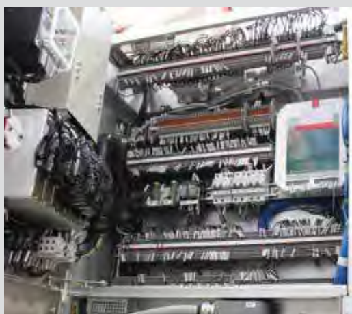
Рис. 1.15. Релейный отсек (вид при открытой двери)
