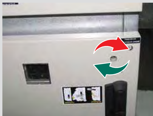
Рис. 2.31. Отверстие аварийного оперирования заземлителем
