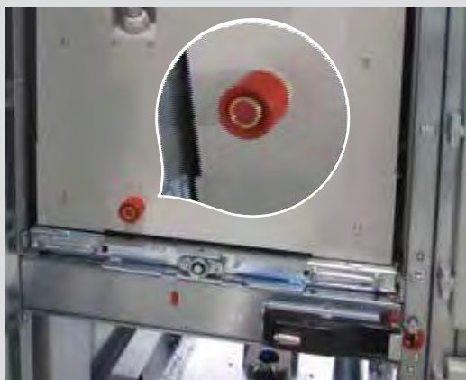
Рис. 2.24. Приемная кнопка ручного отключения выключателя (вид с открытой дверью отсека)
