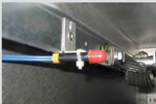
Рис.1.55. Волоконно-оптический датчик в отсеке присоединений
