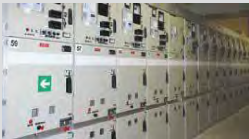
Рис.1.2. РУ 10 кВ на базе шкафов КРУ "Классика"
