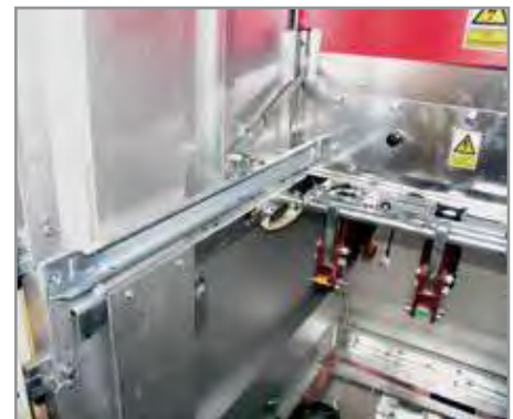
В - Общее рабочее пространство после извлечения КВЭ
