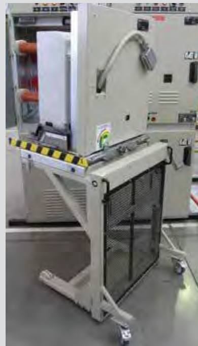
Рис. 2.21. КВЭ в ремонтном положении
